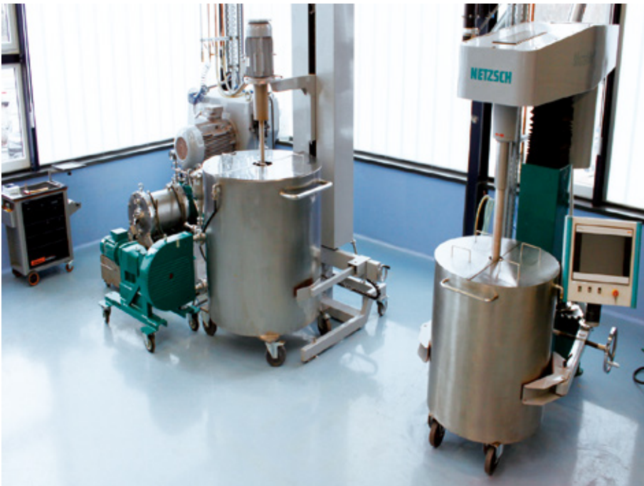
Lohnmahanlage in Selb
