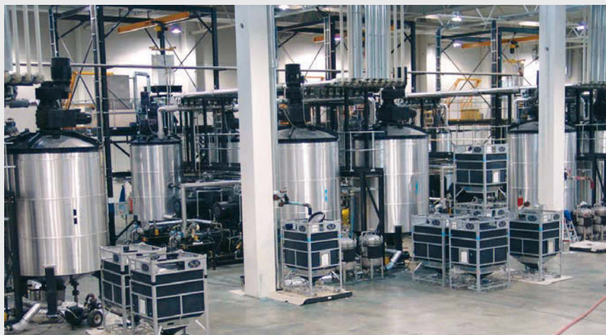
Производственная установка для термоотверждаемых красок
