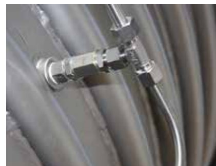
Замывочные головки с наружной стороны ёмкости
