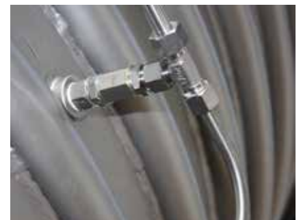
Reinigungsdüsen in der Behälteraußenwand
