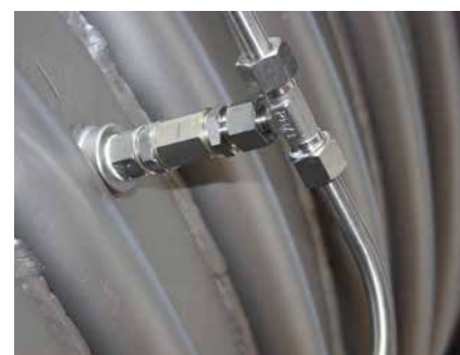
Mlaznice za čišćenje u vanjskoj stijenci spremnika
